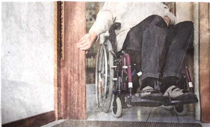
Damit man mit dem Rollstuhl gut durch die Tür kommt und dabei bequem die Arme an den Seiten zum Anschieben haben kann, sollte die Durchgangsbreite 90 Zentimeter betragen.
